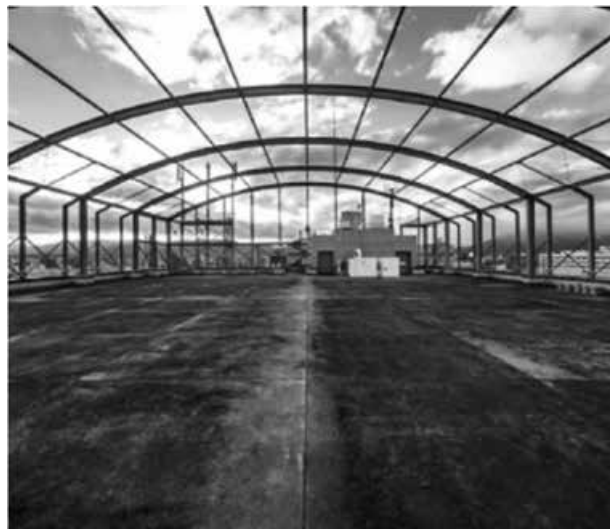
写真-9 テニスコート（改修前）
