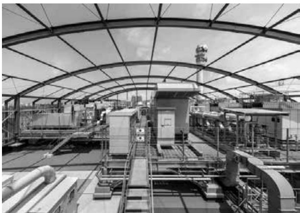
写真8 設備スペース（改修後）
