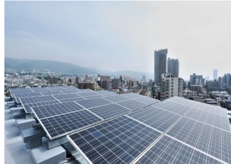
太陽光パネル
